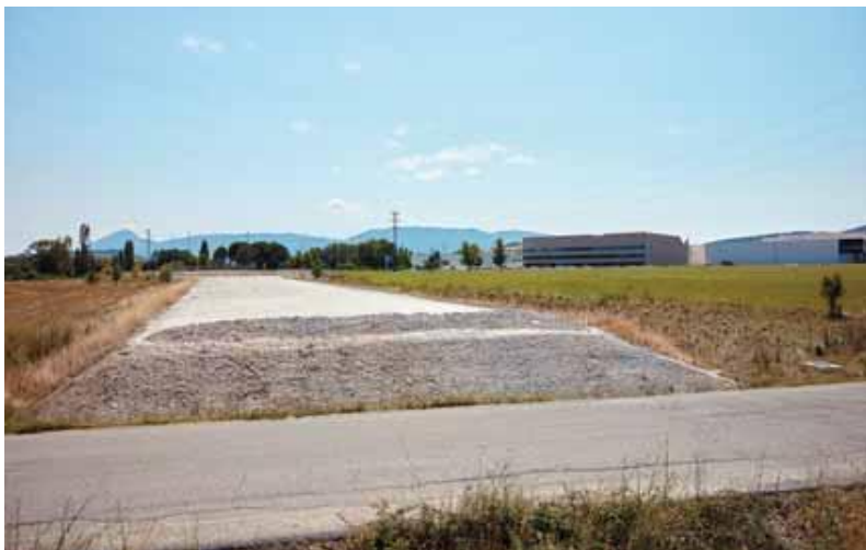
Vista de la ampliación hecha en el polígono, que tampoco ha servido para construir la variante. JESÚS GARZARON
